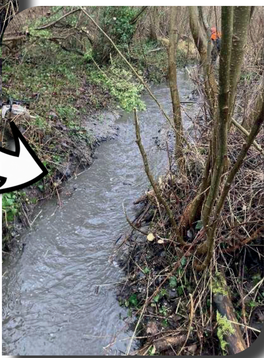
Le ru du Rayon après les travaux : la largeur du lit a été réduite, augmentant ainsi la vitesse d'écoulement et limitant l'envasement de ce dernier.
